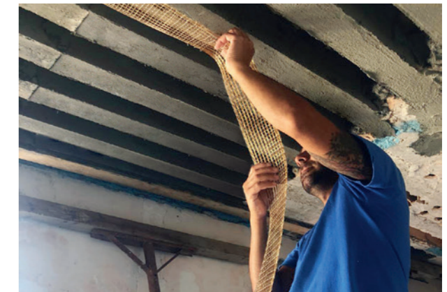
In caso di difetto di armatura si procede al rinforzo strutturale del travetto mediante tecnologia FRCM con PBO-Mesh GOLD 105 e matrice inorganica PBO-MX Gold Calcestruzzo .
