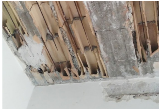
Sfondellamento causato da infiltrazioni che creano dilatazione nei laterizi , con precoce invecchiamento dell'intradosso del solaio abbinato all' ossidazione corrosiva dei ferri d'armatura dei travetti.
