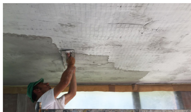
6) Applicazione della malta da intonaco Plasterwall nello spessore di 2 cm (stesa in due mani da 1 cm ciascuna).
