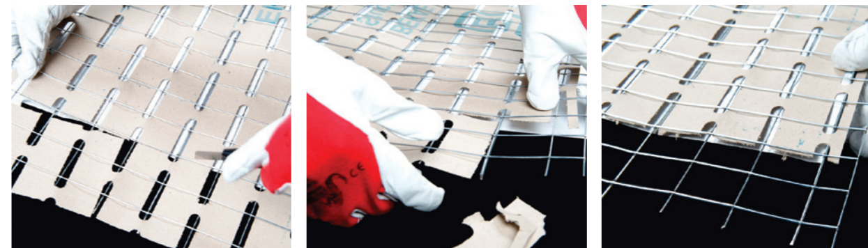
1) Incisione del cartone in corrispondenza di due maglie di acciaio 2) Rimozione del foglio di cartone in eccesso 3) Pannello Stucanet pronto alla sovrapposizione "acciaio su acciaio" su quello adiacente. Le maglie di acciaio dei diversi pannelli vanno sovrapposte e fissate con del fil di ferro per evitare che si distacchino.
