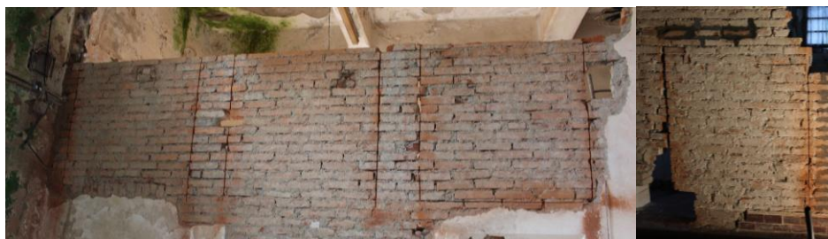
Figura 14. Pannelli non rinforzati.
