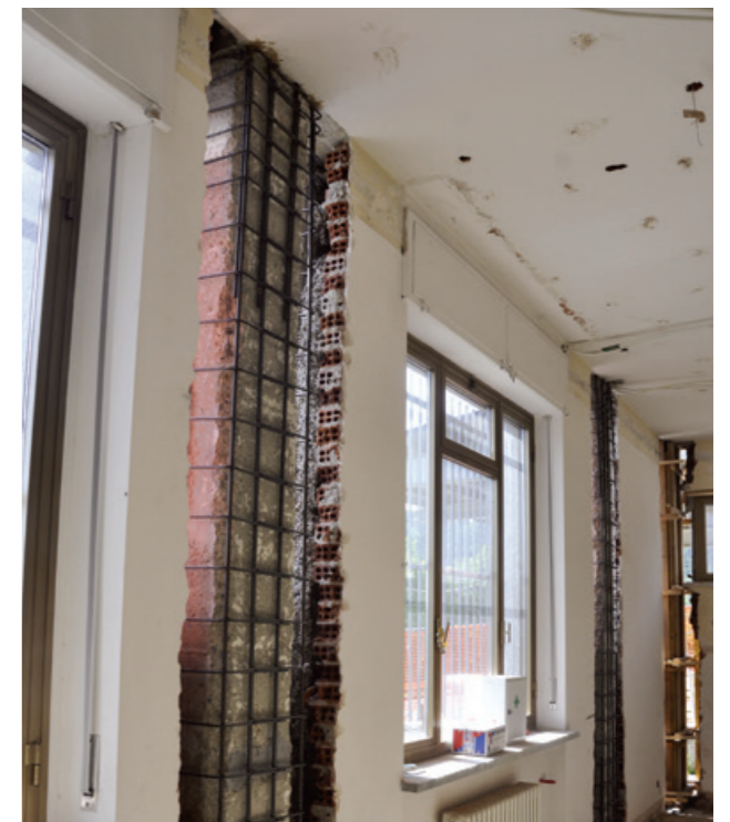
Preparazione del substrato: asportazione dell'eventuale strato ammalorato per incamiciatura del pilastro con Micro Gold Steel .
