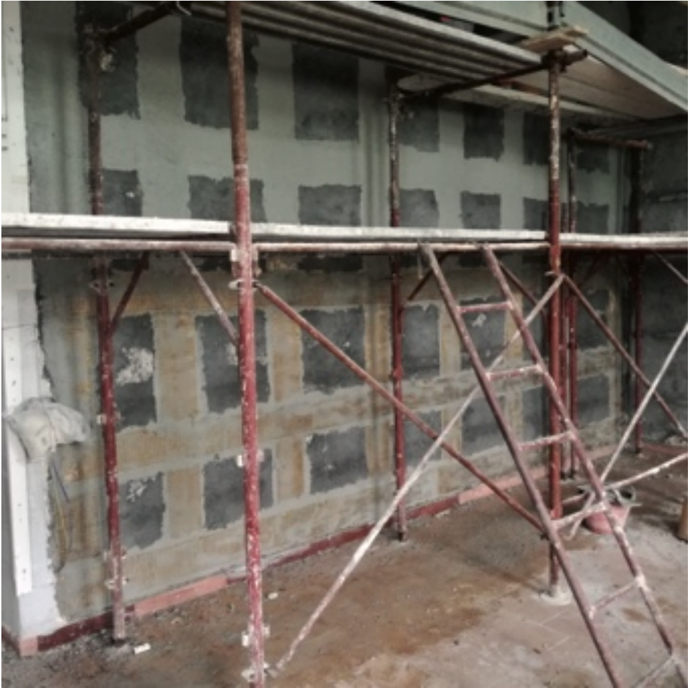
Fig. 47 – Posa in opera della seconda mano di malta sulla rete fibrosa d'armatura
