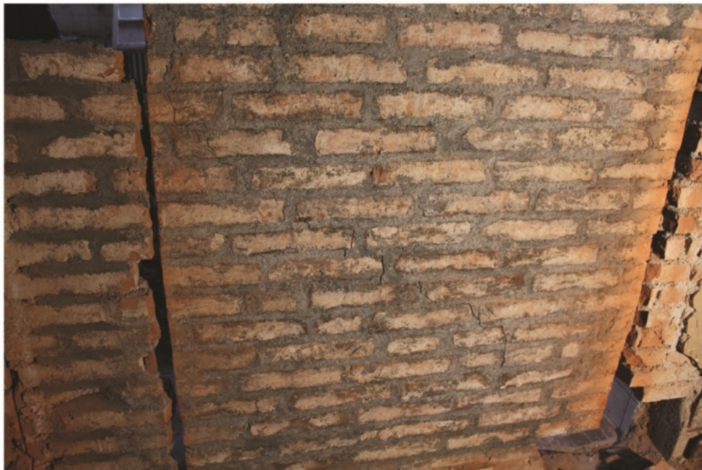
Fig. 46 – Mappa dell'andamento delle lesioni a fine prova su pannello ristilato
