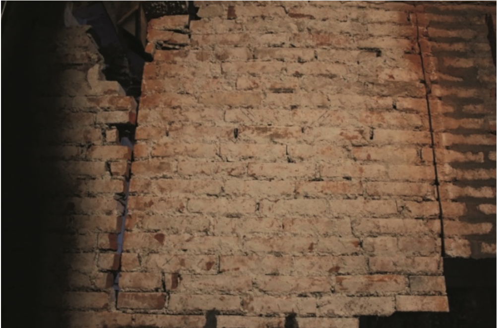
Fig. 45 – Mappa dell'andamento delle lesioni a fine prova su pannello non ristilato
