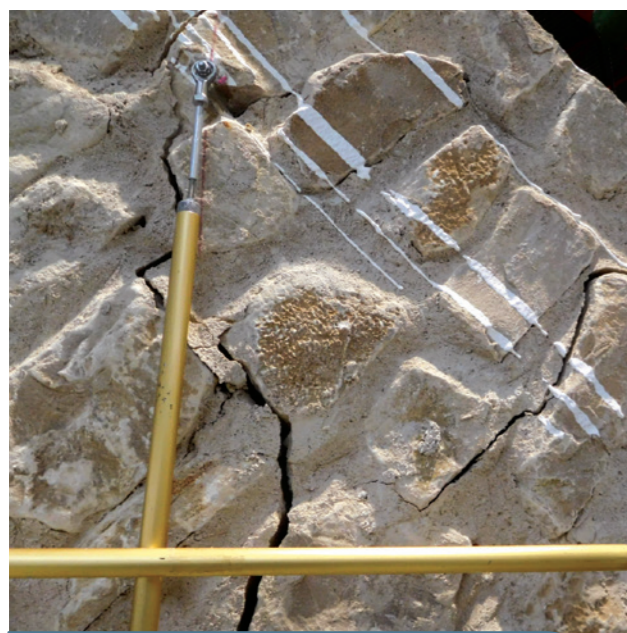
Dettaglio della fessurazione del campione non rinforzato.
