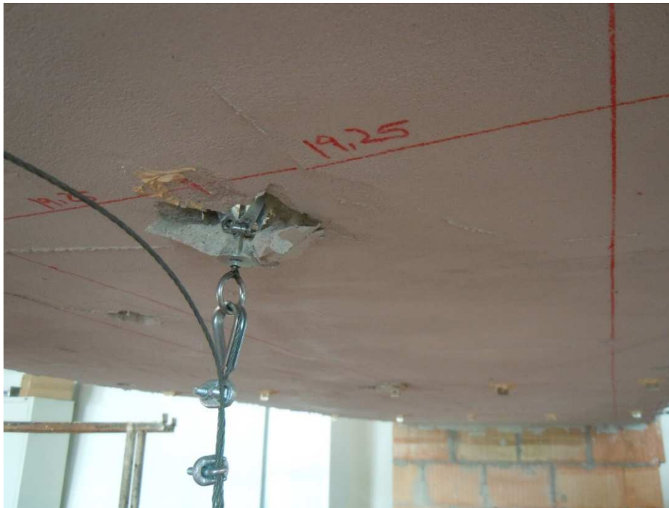
Foto n. 3.8 – Rottura locale del pannello per sfilamento dell'ancora( tassello 2)
