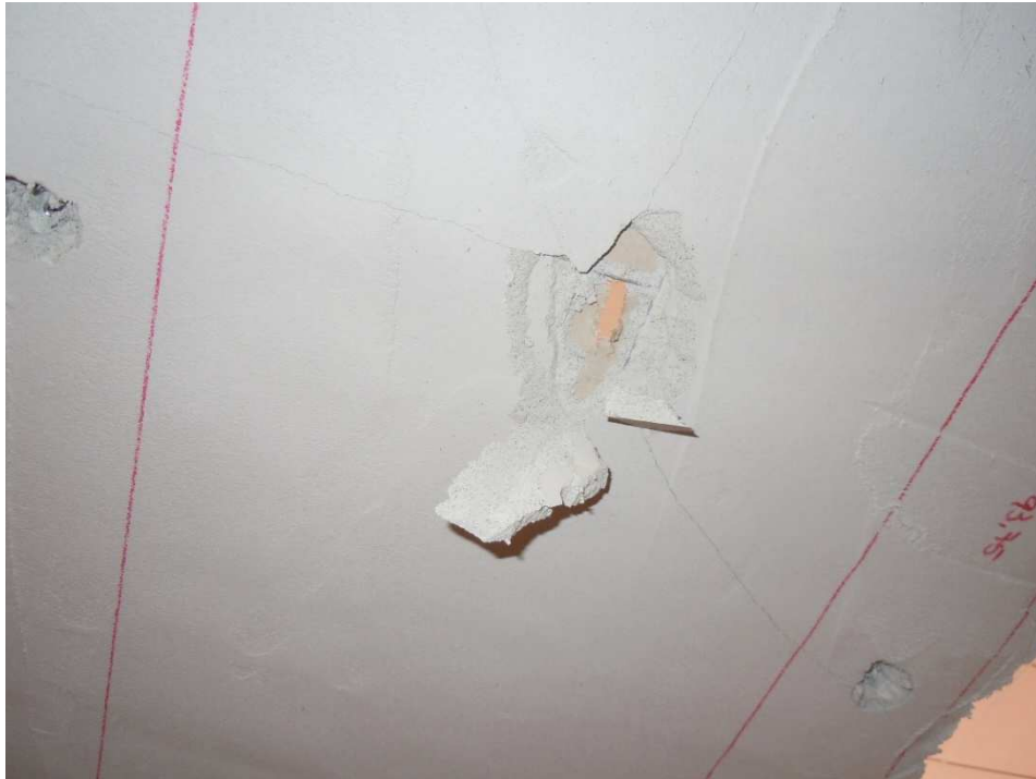
Foto n. 3.4 – Rottura locale del pannello per sfilamento dell’ancora(tassello 1)
