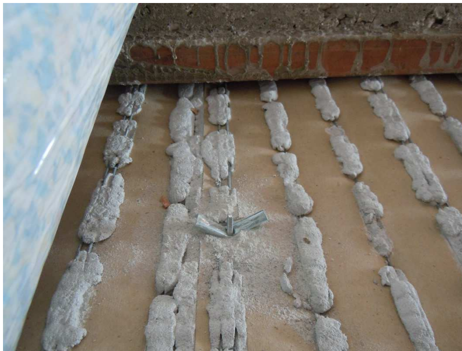
Foto n. 3.14 – Rottura dell’ancora(tassello RIF)
