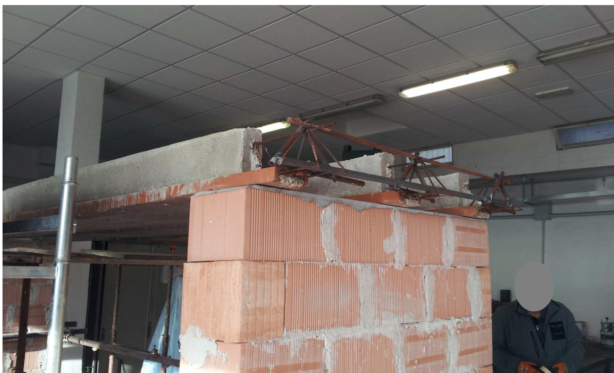
Foto n. 2.1.2 – Assemblaggio in opera del pannello di solaio. Nella foto è visibile la solidarizzazione trasversale dei travetti, mediante saldatura, dopo rimozione delle pignatte
