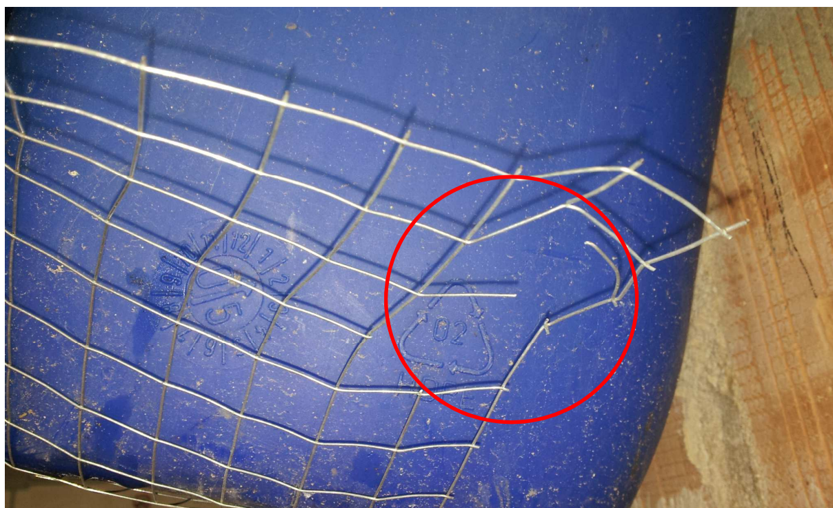
Foto n. 2.2.1.10 – Particolare della rottura delle maglie in corrispondenza di un tassello
