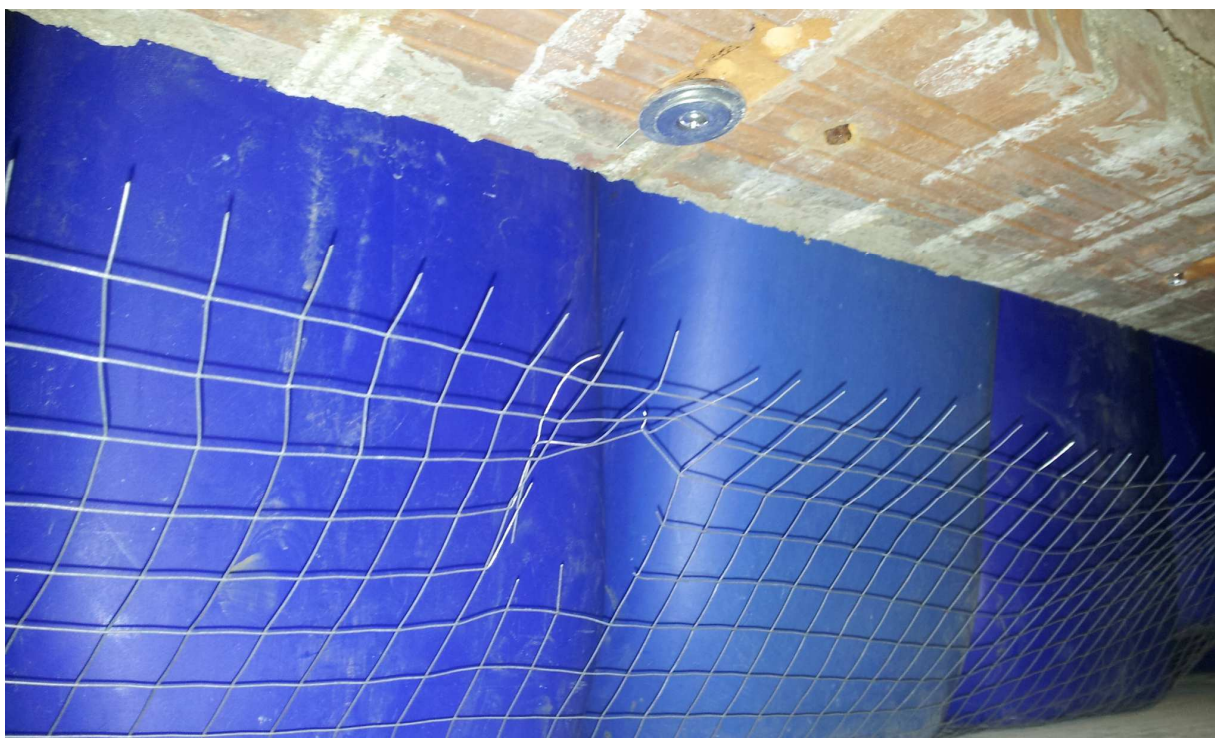
Foto n. 2.2.2.7 – Rottura locale della rete in corrispondenza del fissaggio
