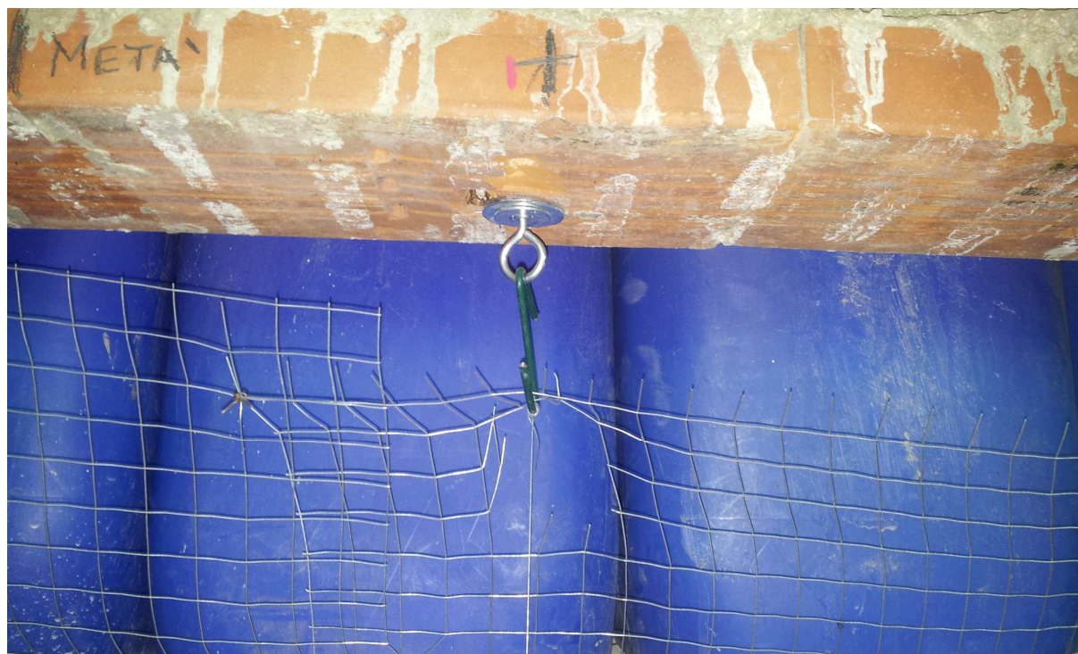
Foto n. 2.2.2.6 – Rottura locale della rete in corrispondenza del fissaggio
