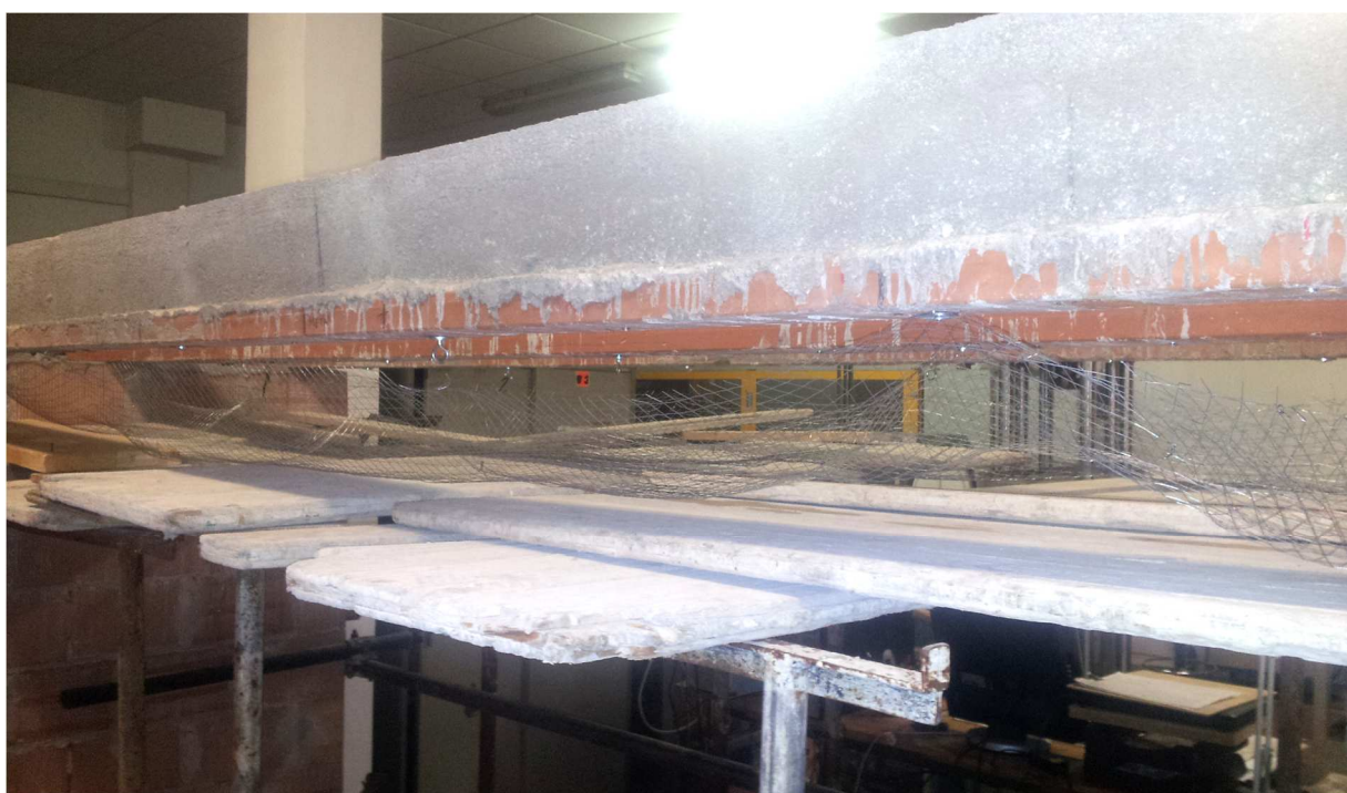
Foto n. 2.2.2.8 – Aspetto della rete dopo la rimozione del carico
