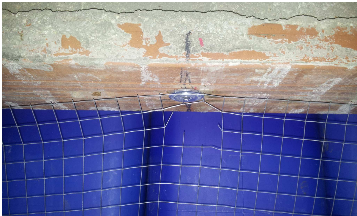
Foto n. 2.2.2.5 – Rottura locale della rete in corrispondenza del fissaggio
