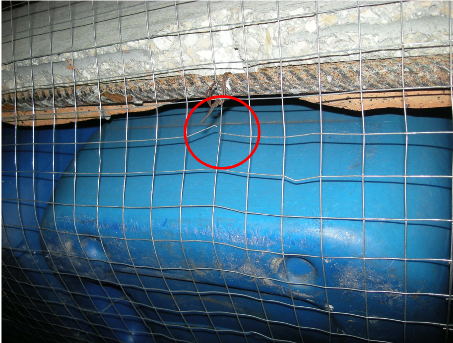
Foto n. 2.2.1.9 – Particolare della rottura di un nodo
