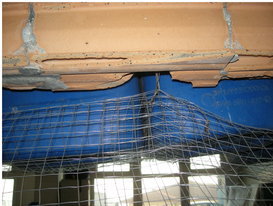
Foto n. 2.2.2.4 – Deformazione della rete in zona di sovrapposizione
