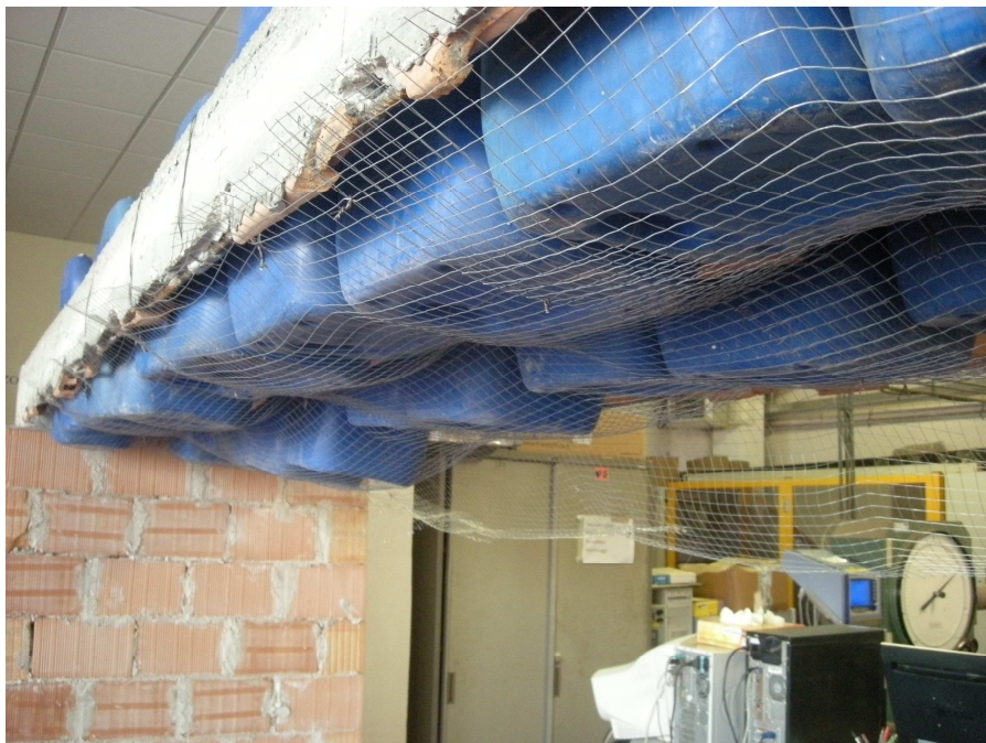
Foto n. 2.2.2.5 – Stato di deformazione della rete non collassata
