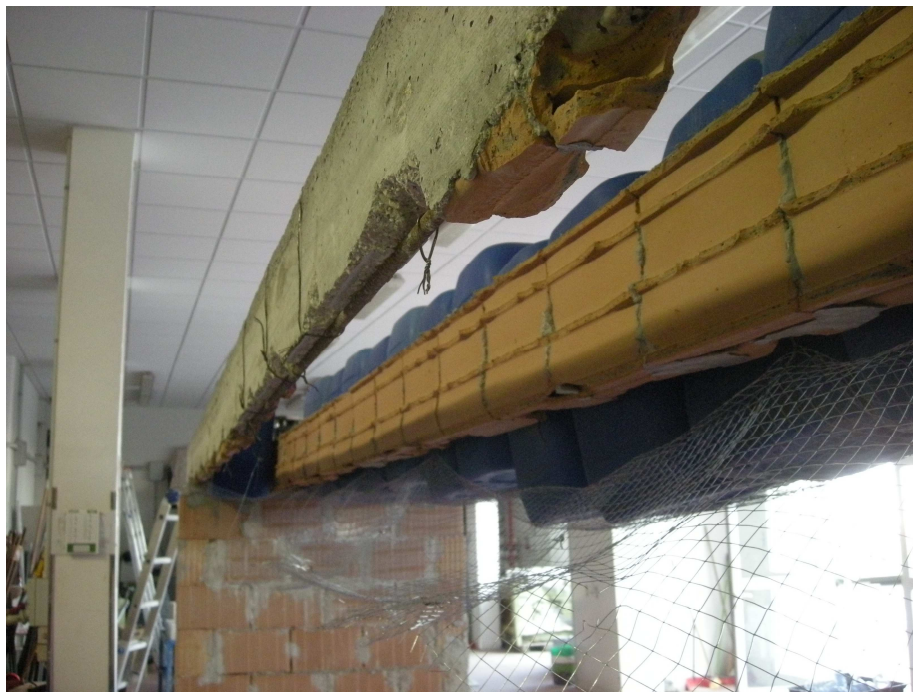
Foto n. 2.2.2.3 – Vista intradossale della zona crollata
