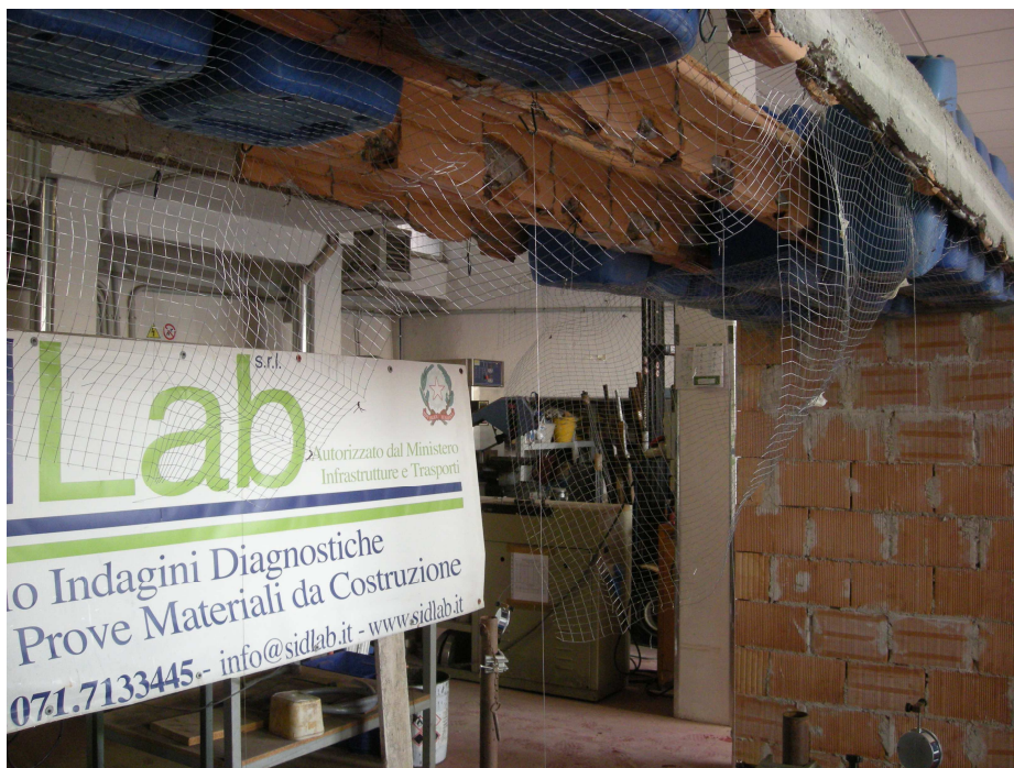
Foto n. 2.2.1.13 – Vista intradossale della zona crollata
