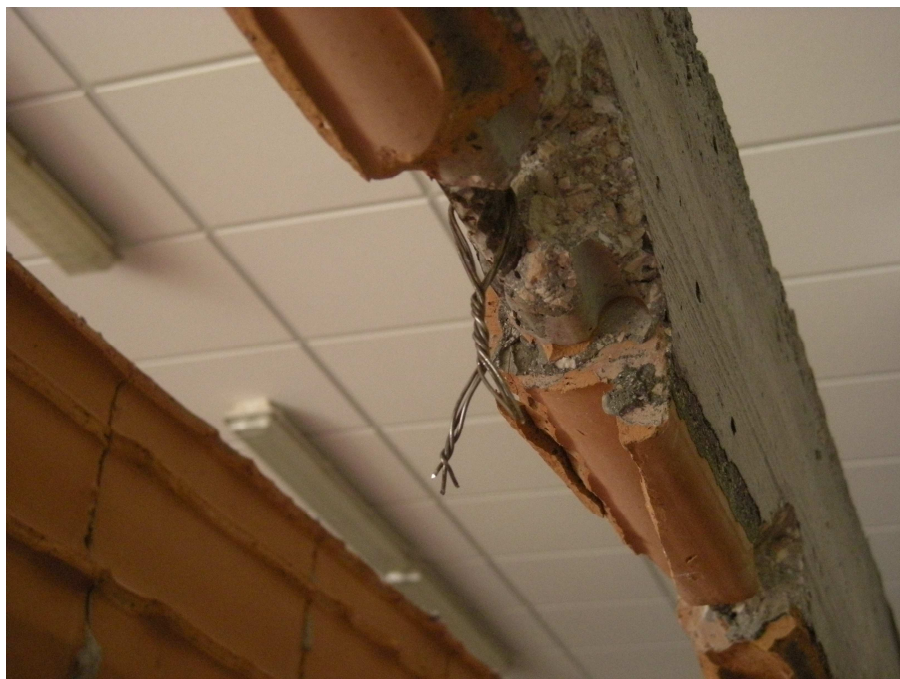
Foto n. 2.2.2.6 – Stato di integrità della legatura a seguito del collasso della rete
